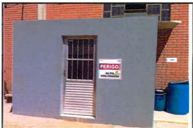
QUADRO DE COMANDO
